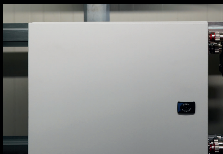
Protezione contro i sovraccarichi in DC
